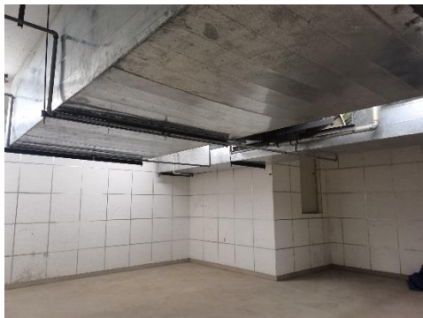
风机房（基础减振措施），安装在地下
