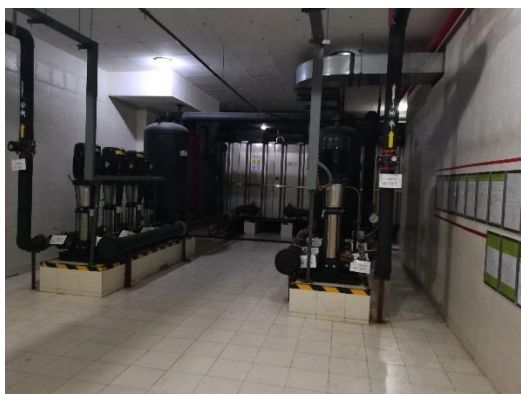
给水泵房（基础减振措施），安装在地下
