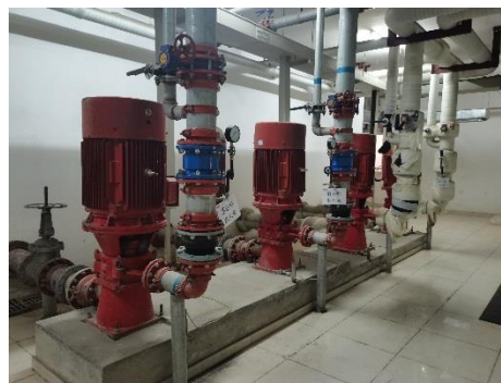
消防泵房（基础减振措施），安装在地下
