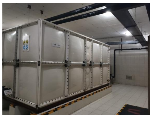
中水泵房（基础减振措施），安装在地下
